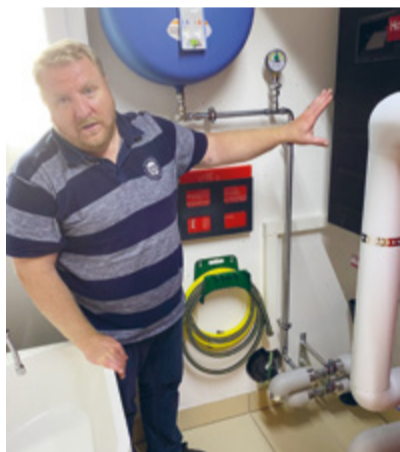
Dominic Teucher zieht eine positive Bilanz: Die neue Heizung arbeitet zuverlässig bei halbierten Energiekosten.
