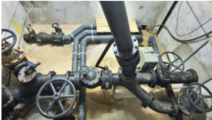
Rohrkeller im Reservoir Haggenberg
