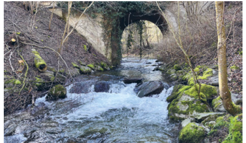
Für Fische unpassierbares Querbauwerk aus Steinblöcken in der Lützelburg bei Aawangen.
