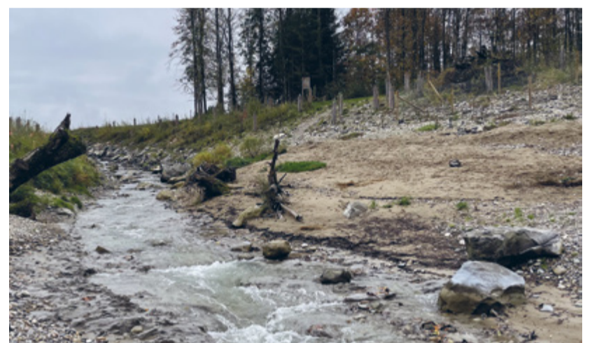
Revitalisierte Mündung des Rütibachs in Bürglen TG, Entfernung eines vier Meter hohen Absturzes, Ersatz durch Stufenbeckenfischpass und neu geschaffene Lebensräume.
