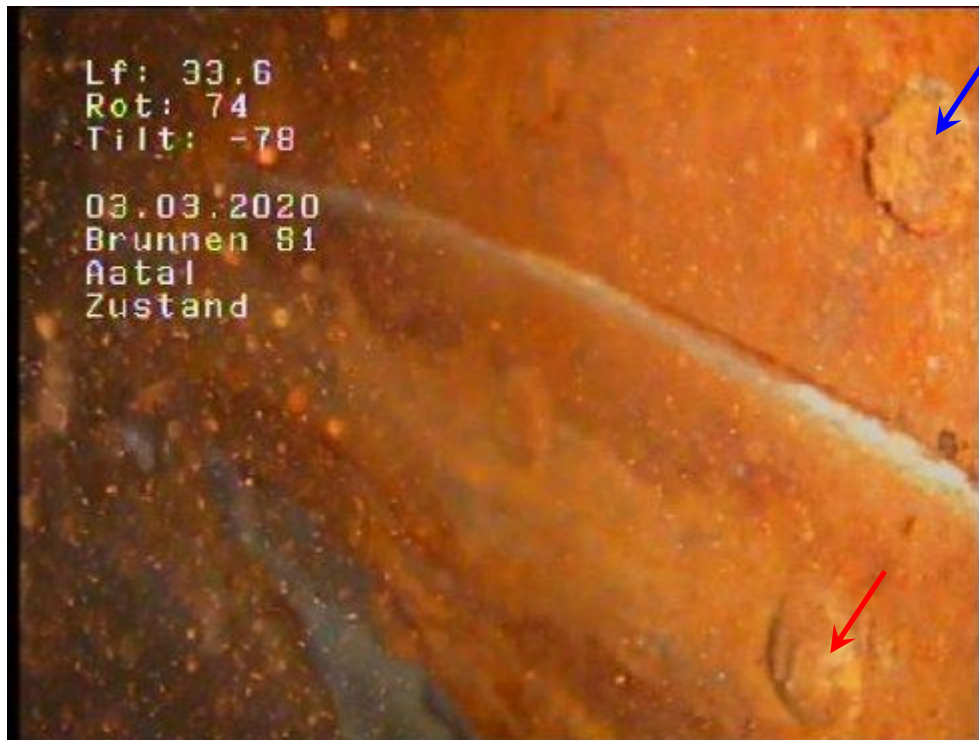
Bild 21: Tiefe 33,6 m 1000-mm-Stahl-Filterrohr Außenlaschenverbindung am Übergang vom Filterabschnitt zum Sumpfrohr. Die Nietköpfe und die Gewindebolzen sehen unauffällig aus. Keine Hinweise auf nennenswerte Korrosion.
