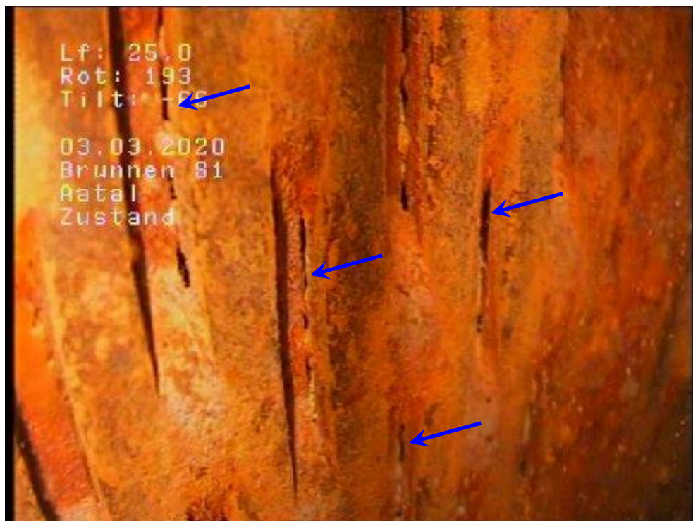
Bild 10: Tiefe 25,0 m 1000-mm-Stahl-Filterrohr Oberes Drittel der Filterstrecke. Die Filterschlitze sehen verengt aber noch weitgehend frei und wasserdurchlässig aus.
