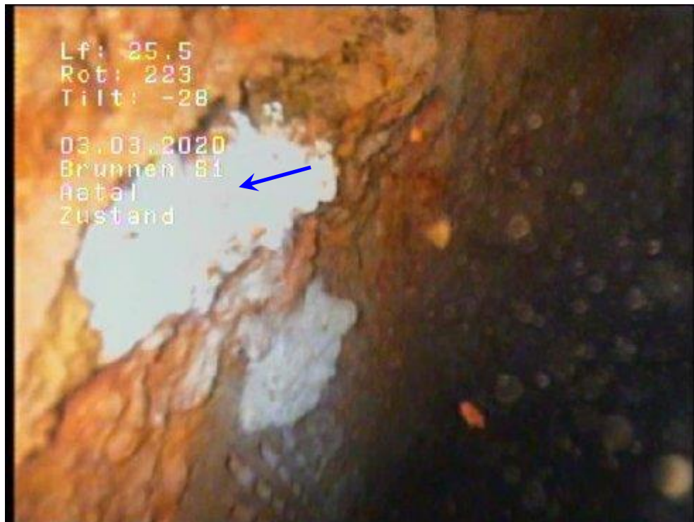
Bild 11: Tiefe 25,5 m 1000-mm-Stahl-Filterrohr Vermutlich Loch im Filterrohr kurz oberhalb einer Rohrverbindung. Im freigelegten Loch scheint hellgraues mineralisches Material zu stecken. Möglicherweise ist das Metall noch als dünnes filligranes Material vorhanden. Filterkiesel sind nicht erkennbar. Möglicherweise handelt es sich bei dem hellgrauen Feinmaterial um zerriebene Filterkiesel. Nach unserer Einschätzung wird die Schadstelle eine Hochdruckreinigung nicht überstehen.
