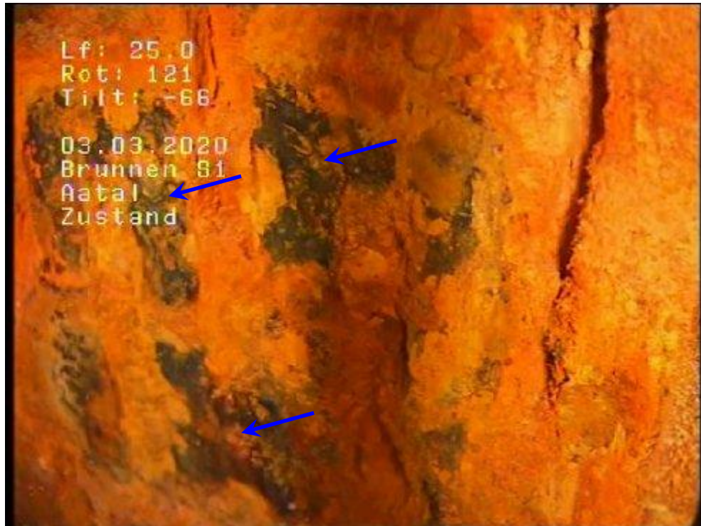
Bild 9: Tiefe 25,0 m 1000-mm-Stahl-Filterrohr Scheuerstelle am Filterrohr. Deutliche Scheuerwirkung am Filterrohr erkennbar. Bis dato noch kein Loch erkennbar. Vermutlich durch die Flansche des Pumpensteigrohres verursacht.
