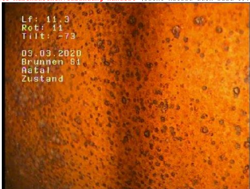
Bild 2: Tiefe 11,3 m 1500 mm Stahlsperrrohr Blick auf das 1500 mm Stahlsperrrohr. Es gibt keine Hinweise auf eine Verzinkung oder einen anderen Korrosionsschutz. Möglicherweise war ein bituminöser Schwarzanstrich (Inertol) vorhanden. Dieser dürfte dann aber vollständig abgelöst sein. Das sichtbare Metall zeigt flächige Korrosion (pockennarbige Oberfläche) ohne erkennbaren Lochfraß. Dieselbe Korrosionserscheinung ist auch auf der Rohraußenseite zu erwarten.
