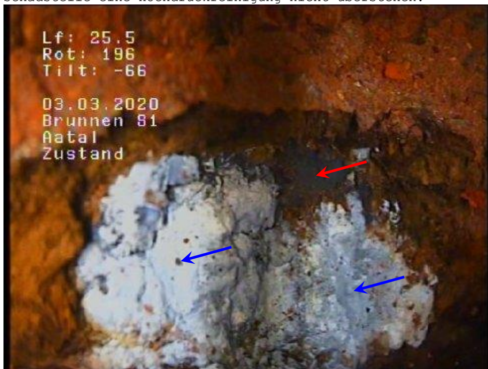
Bild 12: Tiefe 25,5 m 1000-mm-Stahl-Filterrohr Detailaufnahme des vermuteten Lochs im Filterrohr. Das Metall dürfte nur an einer kleinen Stelle sichtbar sein. Im freigelegten Loch scheint hellgraues mineralisches Material zu stecken. Möglicherweise handelt es sich bei dem hellgrauen Feinmaterial um zerriebene Filterkiesel.
