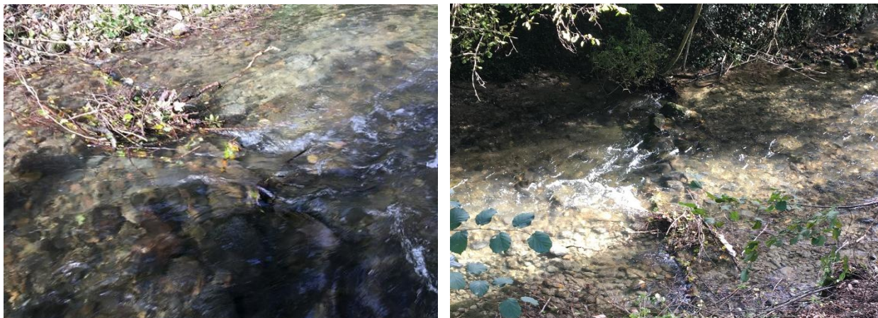
Abbildung 15: Schwelle Nr. 11, Ansicht von unten (links) und oben (rechts). NRP Ingenieure AG, 07.10.2024
